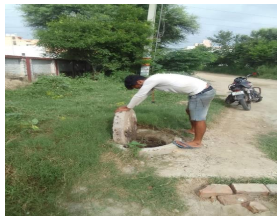
Effluent diversion chamber Phase-III
